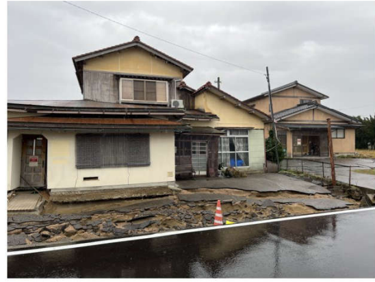
液状化現象の被害を受けた住宅
