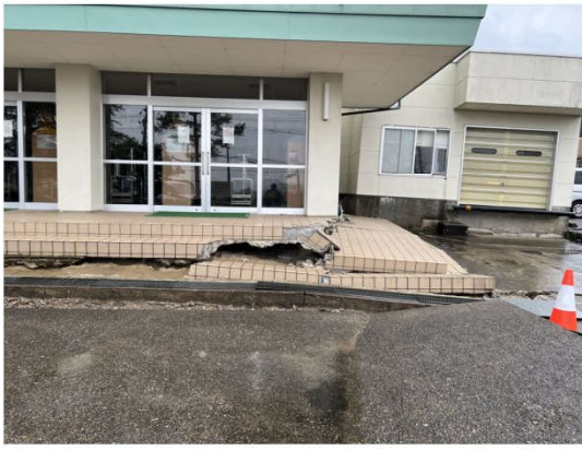
液状化現象の被害を受けた学校
