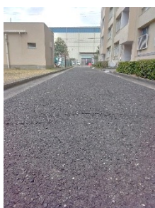
アスファルト 舗装の段差
