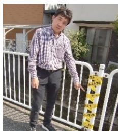
腐食している柵
