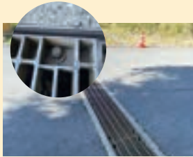
根本町 グレーチング側溝蓋対応
